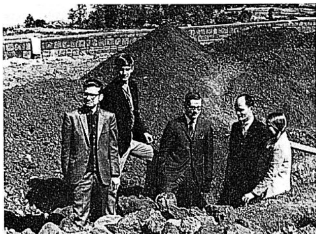
Medlemmarna i den kanadensiska delegationen till panchganikonferensen inspekterar grundgravningarna för en ny matsal, vars finansiering de tagit ansvar för.
